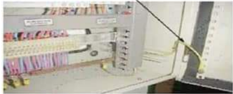
خزانة مراقبة كهربائية مجهزة بسلك أرضي.
