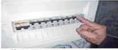
مجموعة من القواطع الكهربائية
